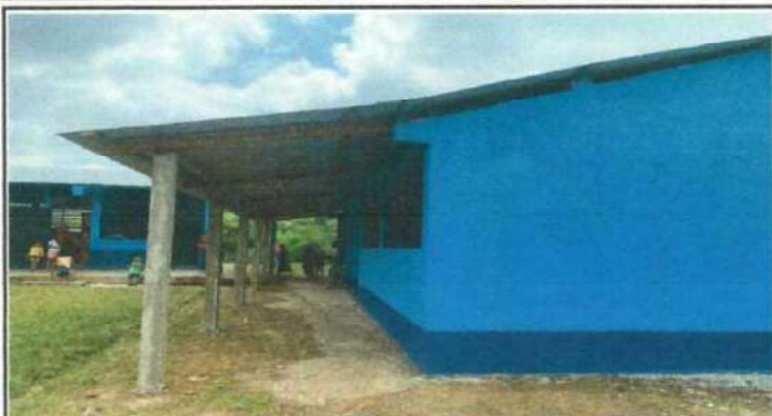
Foto1: PISO REQUIERE SUSTITUCION EN EL CORREDOR DEL AULA
